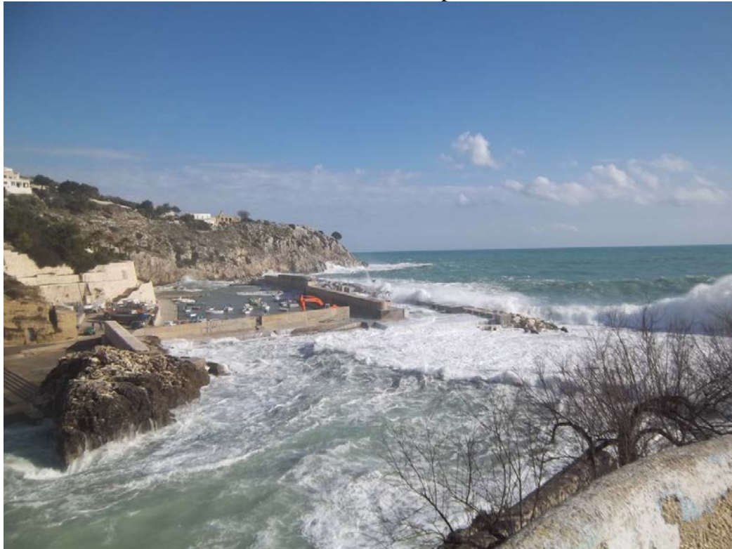
2.2. Mareggiata durante i lavori - 2012 Assenza di scavalcamento del muro paraonde
